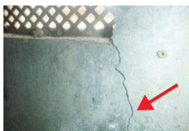
基礎ひび割れ(内部)
