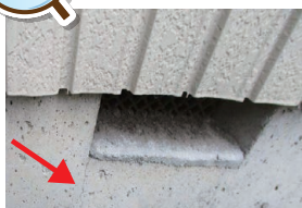
基礎ひび割れ(外部)
