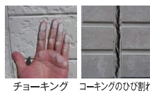
チョーキング コーキングのひび割れ
