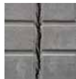
コーキングのひび割れ
