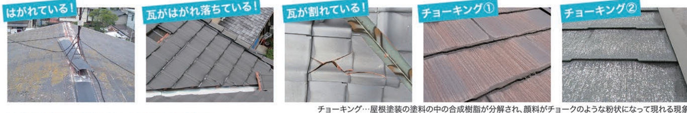
チョーキング…屋根塗装の塗料の中の合成樹脂が分解され、顔料がチョークのような粉状になって現れる現象
